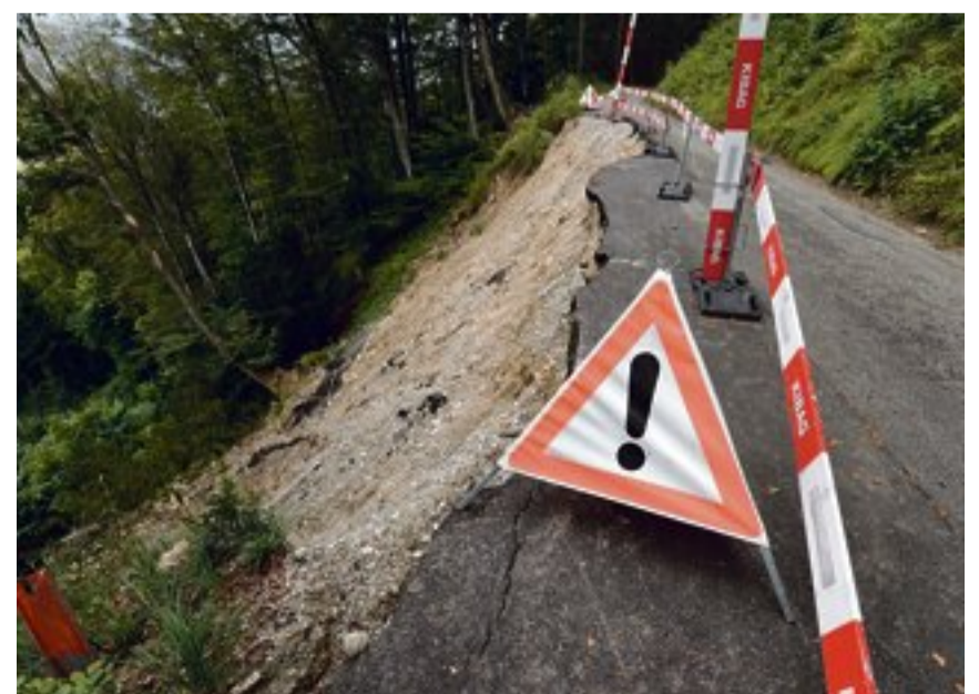
Die Burgerversammlung hat einstimmig beschlossen, die stark beschädigte Strasse auf die Alp Hinteregg rasch zu reparieren.
